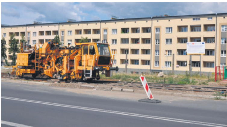
Modernizacja linii tramwajowej i wzbogacenie taboru. Wartość zadania - 220 350 720,96 zł; dofinansowanie z środków UE - 149 301 947,42 zł. fot. UM Częstochowy
